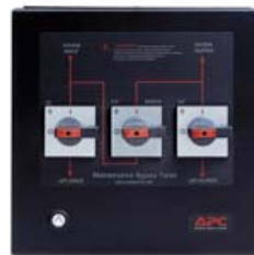
By-pass de mantenimiento
